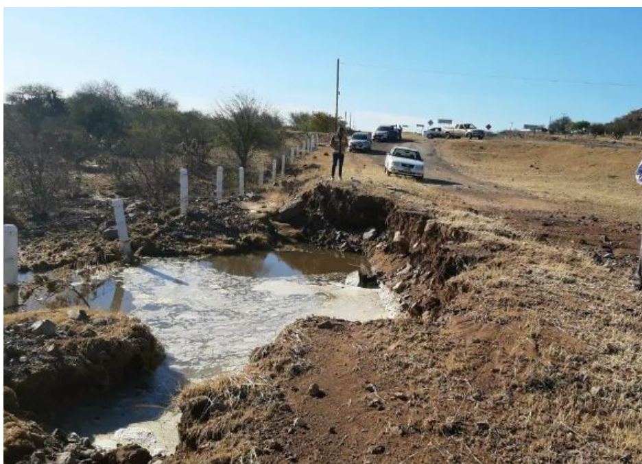
Lo que constituiría la novena falla en lo que va del año de El Realito, se registró la tarde del pasado lunes 14 de septiembre cuando el acueducto guanajuatense interrumpió el suministro a la ciudad de San Luis Potosí.
