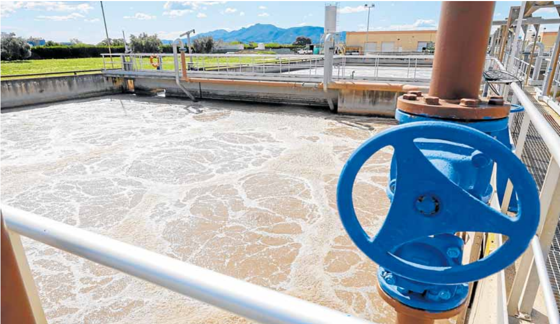
Instalaciones de una planta depuradora. IRENE MARSILLA
